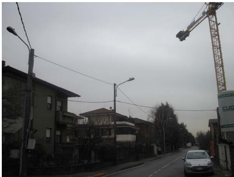
Via Alcide de Gasperi: giunzioni di cavi su sostegno in c.a.c.
