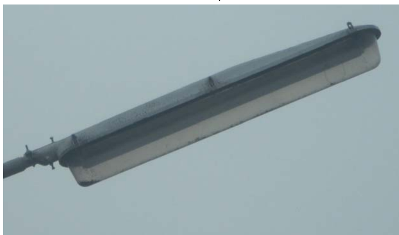
Armatura stradale con lampada fluorescente diffondente- vetusta
