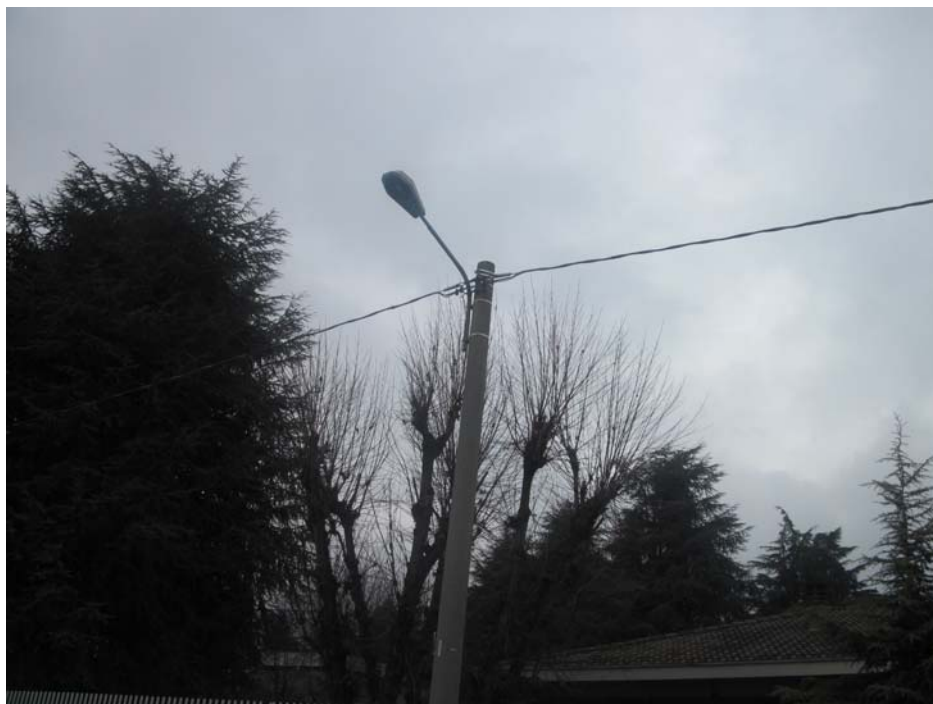
Via Adige: impianto di illuminazione con linea aerea
