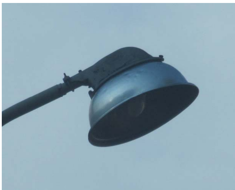
Armatura stradale con ottica aperta diffondente-vetusta
