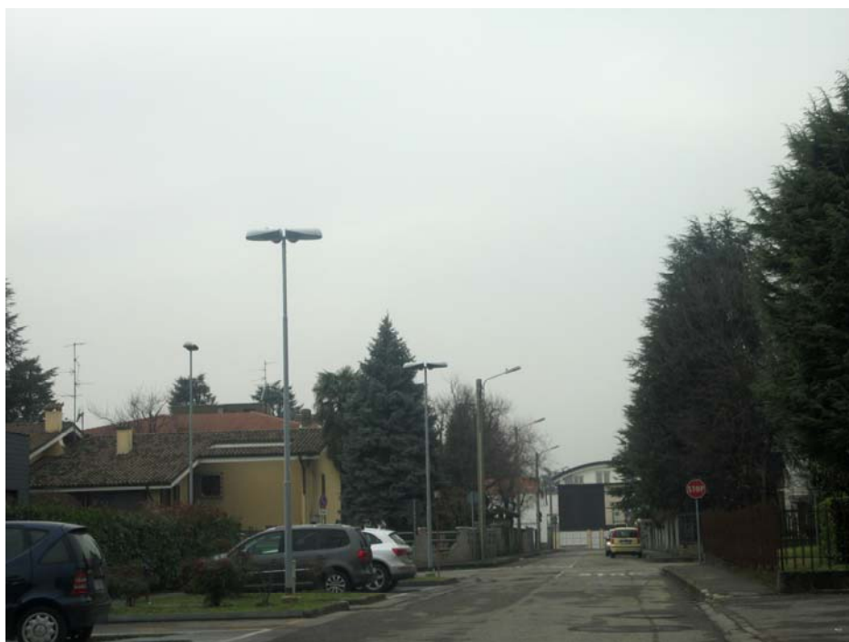
Via Cadore: impianto di illuminazione con linea interrata
