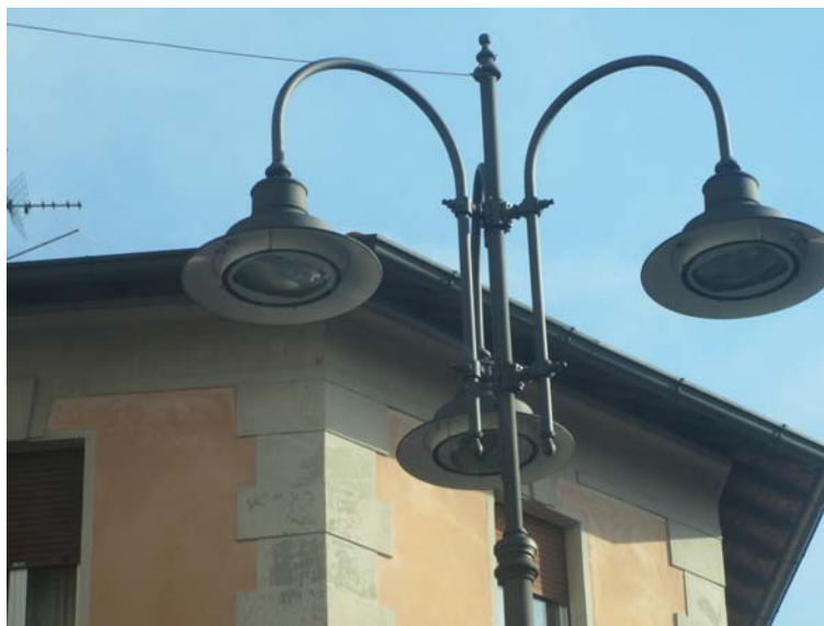
Via della Libertà: apparecchi di arredo urbano conformi alla L.R. 17/2000 e alla L.R. 38/2004
