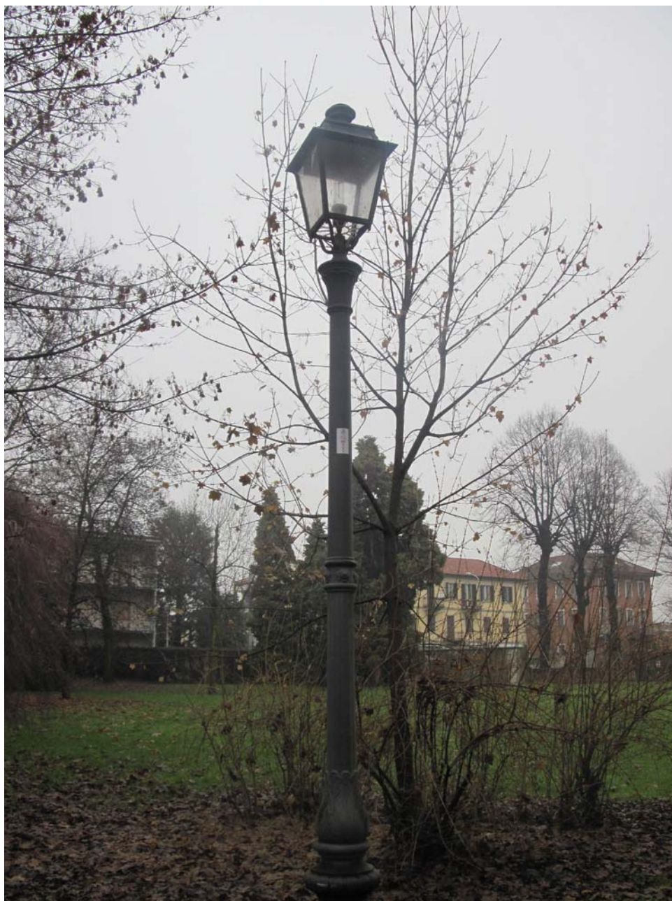
Lanerne installate all'interno del parco di Villa Zoja. Tali apparecchi di illuminazione non risultano compatibili con la L.R. 17/2000 e alla L.R. 38/2004 in quanto diffondenti.
