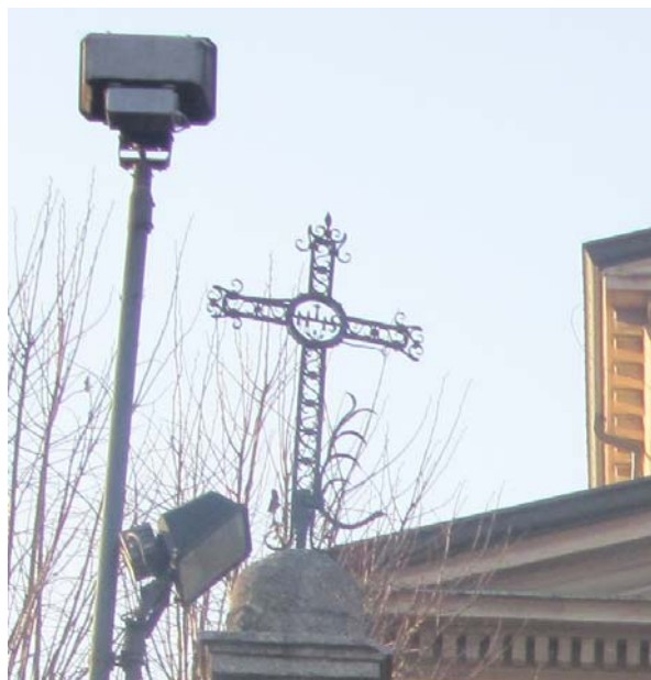
Proiettore per l'illuminazione della facciata della Chiesa dei Santi Cosma e Damiano
