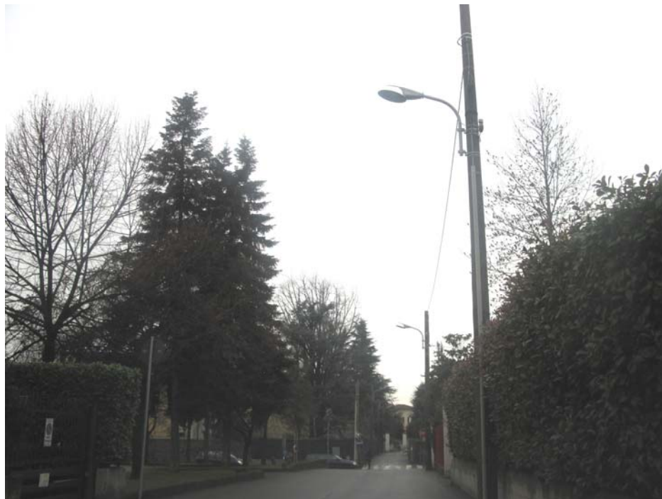
Via Sant'Agata: impianto di illuminazione vetusto costituito da armature stradali aperte e diffondenti dotate di lampade obsolete ai vapori di mercurio
