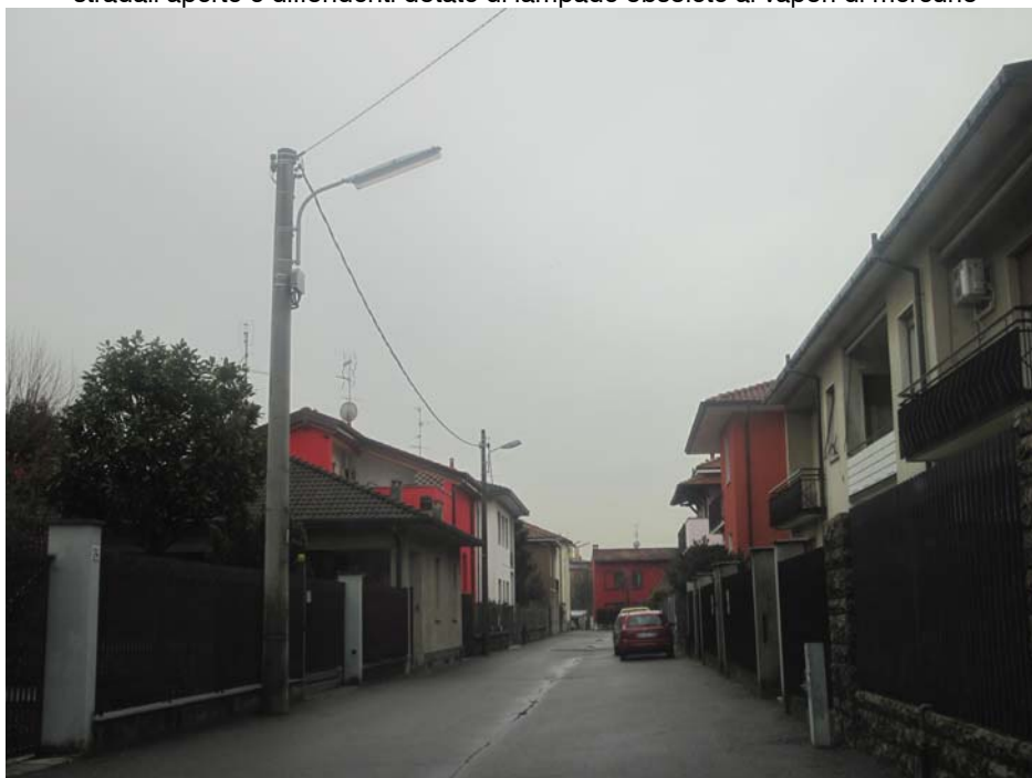
Via Galileo Galilei: impianto di illuminazione costituito da armature stradali diffondenti dotate di lampade tubolari fluorescenti
