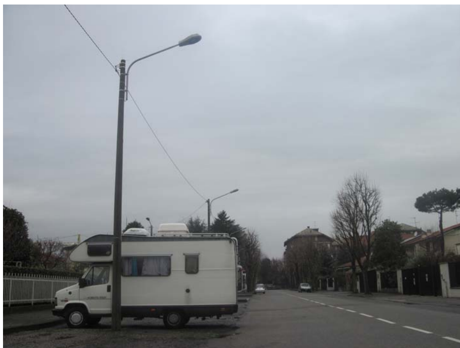
Via Enrico Fermi: apparecchi di illuminazione installati su sbracci verniciati su pali c.a.c.
