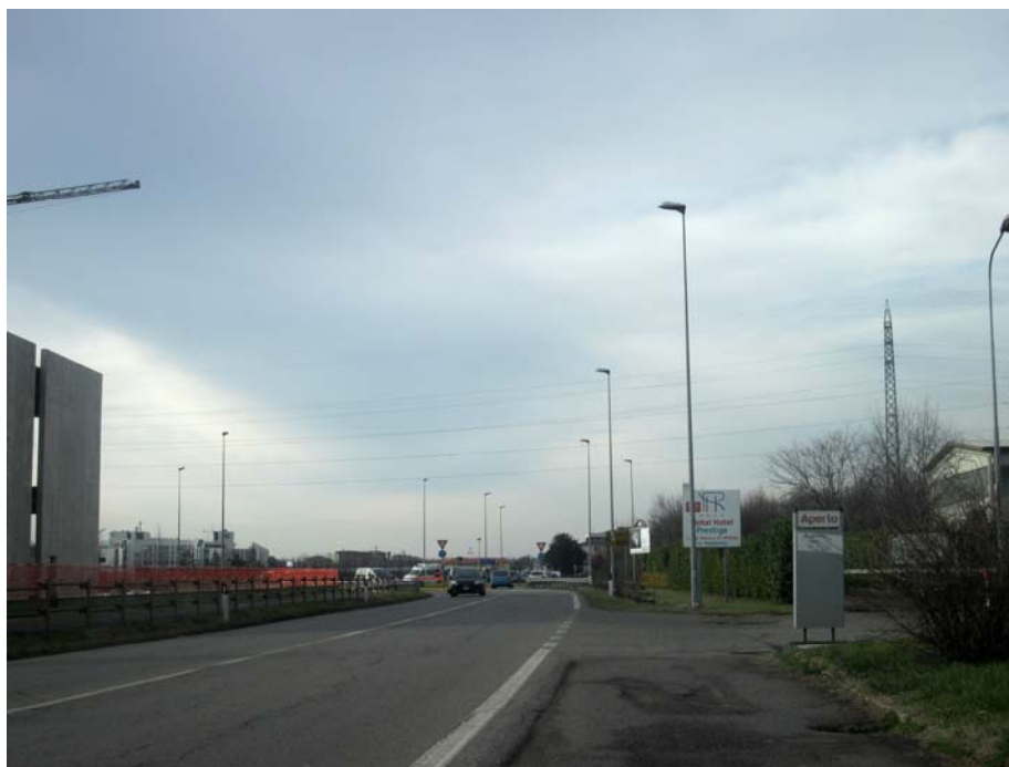
Strada Provinciale n. 2 Monza Melzo: armature stradali totalmente schermate installate su palo
