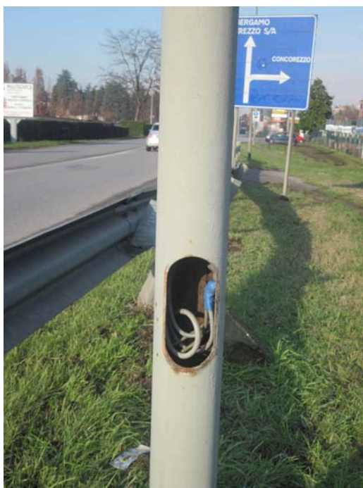
S.P. n. 3 Milano – Imbersago: palo danneggiato
