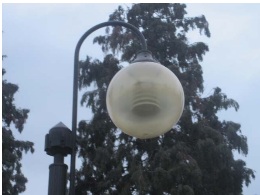
Viale di ingresso al Cimitero: globi diffondenti non compatibili con la L.R. 17/2000 e la L.R. 38/2004
